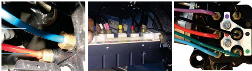
Beispiel verschiedener Leitungen
